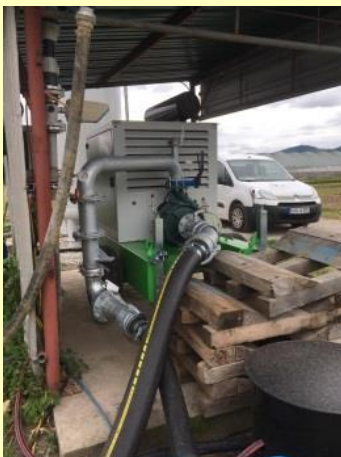
Pumpenaggregat Foto: A. Stief Landwirtschaftsamt Rastatt
