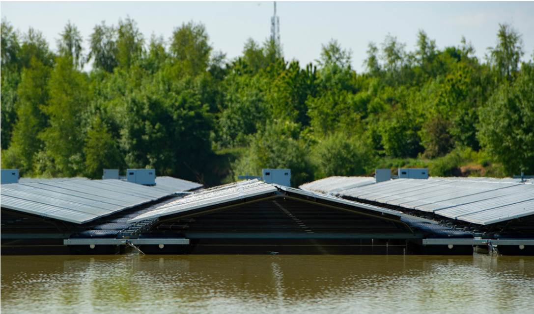
Abbildung 3: Seitenansicht einer PV-Anlage (Quelle: Zimmermann PV-Floating)
