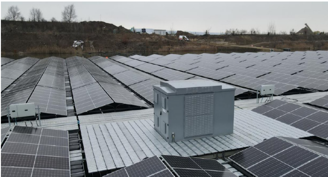
Abbildung 15: Schwimmende Transformatorstation (Quelle: Zimmermann PV-Floating)
