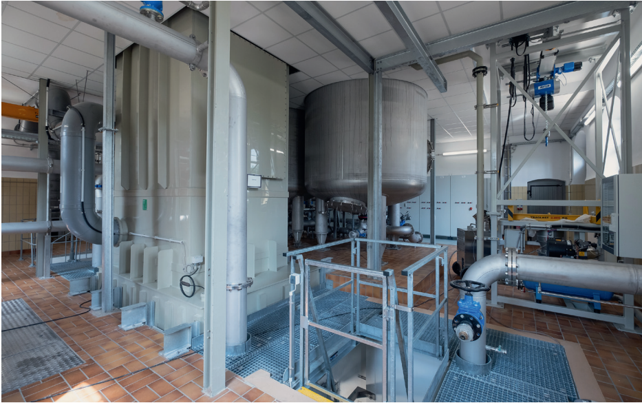
Im Wasserwerk Rauental werden PFC aus dem Grundwasser gefiltert.
